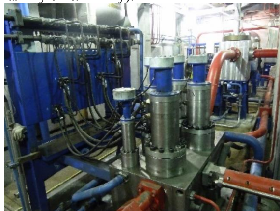
Рисунок 2. Вид части гидрооборудования гидросистемы штамповочного пресса двойного действия П4654 силой 40/65 МН после модернизации, проведенной специалистами УриЦ с применением клапанных модулей
